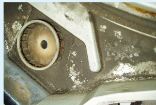
ドレンパン洗浄前
